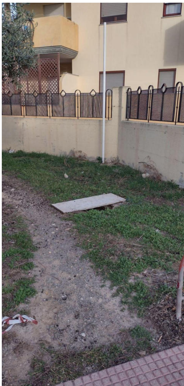
Foto 5 - sentiero tra i civv. 36 e 38 di via Andorra che conduce all'area 6. L'asse di legno copre maldestramente una voragine del diametro di 50 cm e profonda 1 m circa, con tubazioni a vista.
