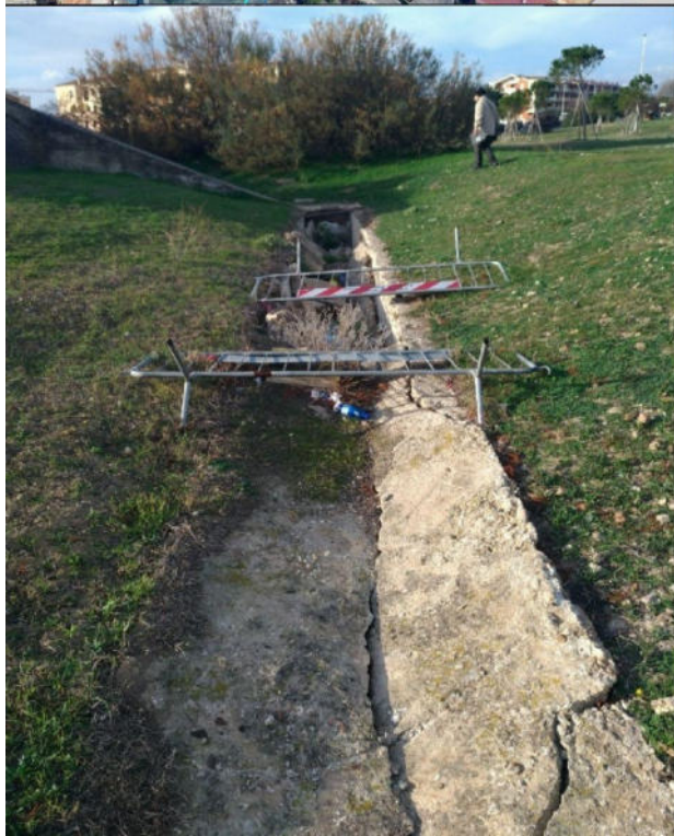
Foto 3 - sottopassaggio crollato che collega i due bunker (area 5)
